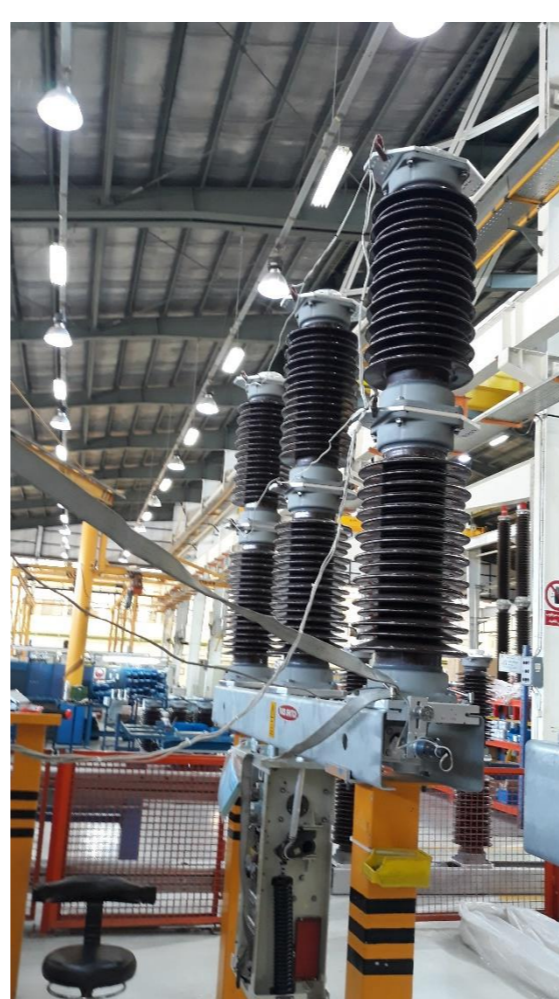
شکل ۳- یک کلید EDF - ۳۶ کیلوولت در حال انجام تست انکودر زاویه ای و گیره های تشخیصی قطع و وصل جریان قابل مشاهده اند.
